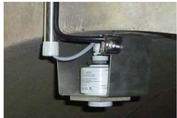
Bild 8 Ultraschallsensor verbaut im Rohrscheitel DN 2800
